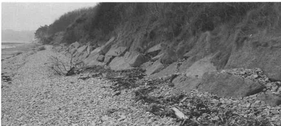
Enrochements anciens. Sous réserve d'une analyse approfondie, ils n'ont plus vocation à être autorisés aujourd'hui (absence d'enjeu).
