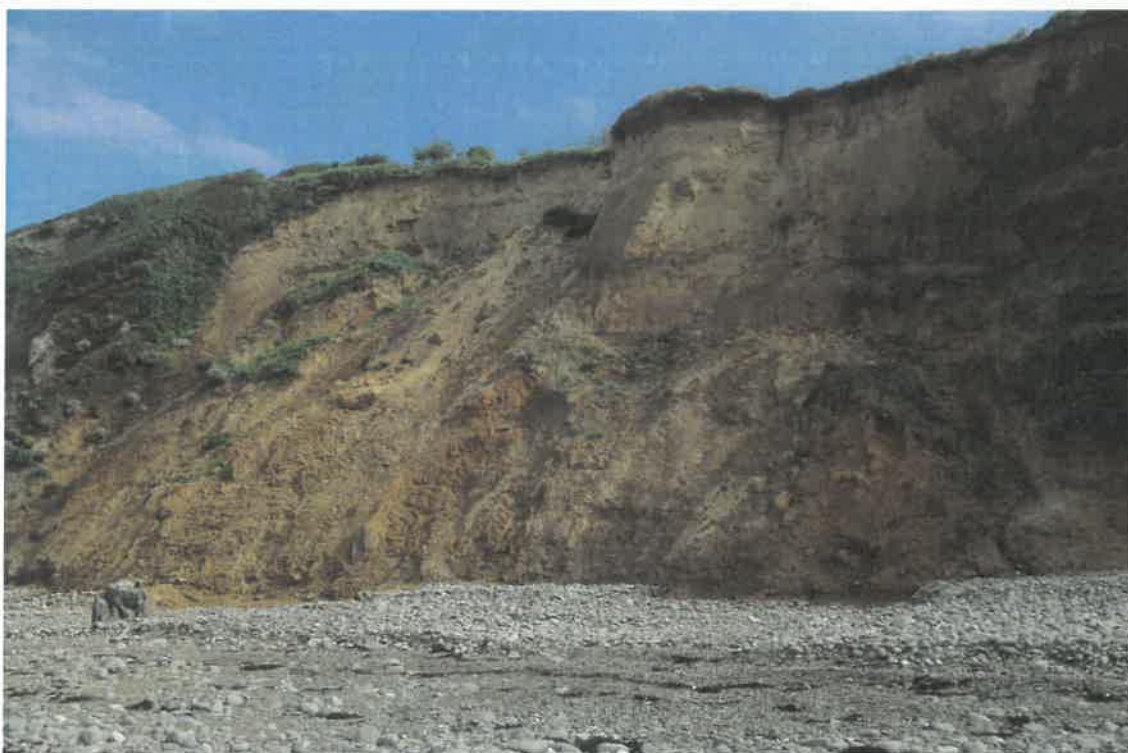
PLENEUF-VAL-ANDRE – Effondrement d'une falaise meuble
